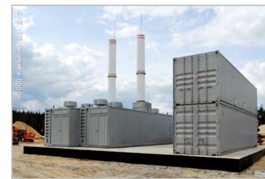
Блок-модули двухтопливной котельной 7 МВт
