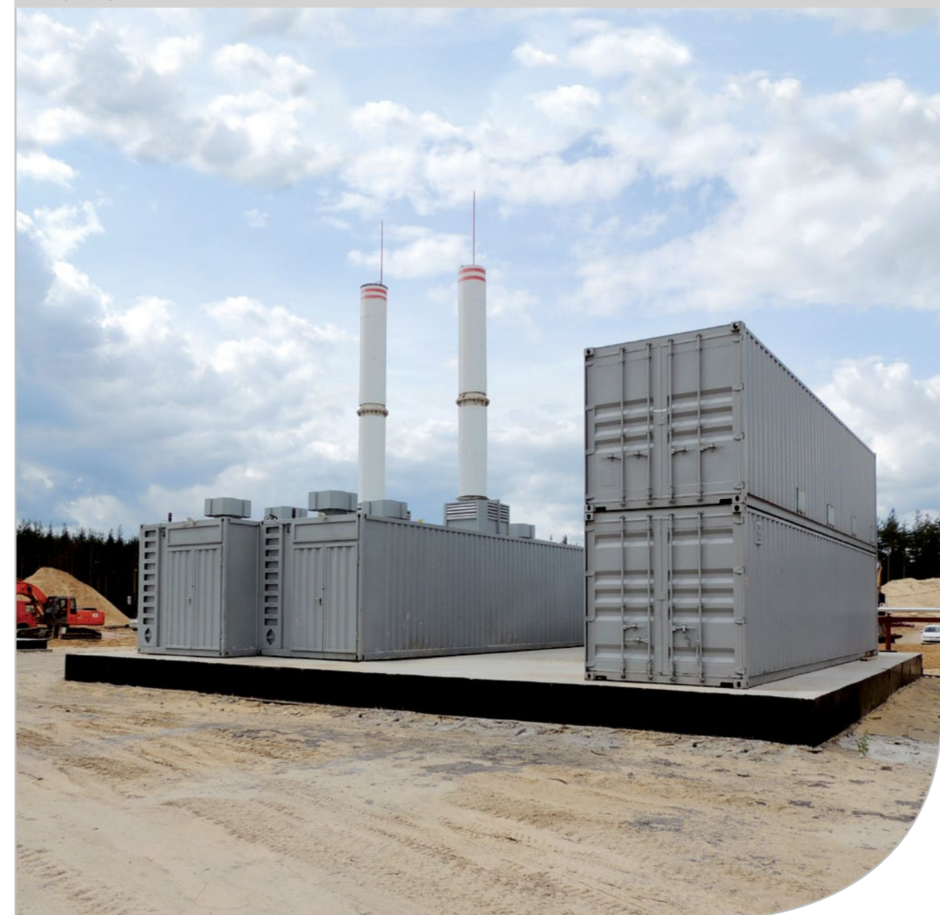
Модули двухтопливной пиковой котельной 7 МВт
