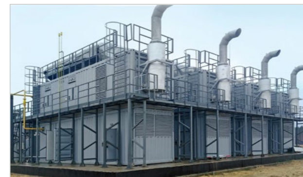
Газопоршневая электростанция 12,8 МВт
