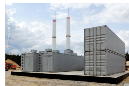
Блок-модули двухтопливной котельной 7 МВт
