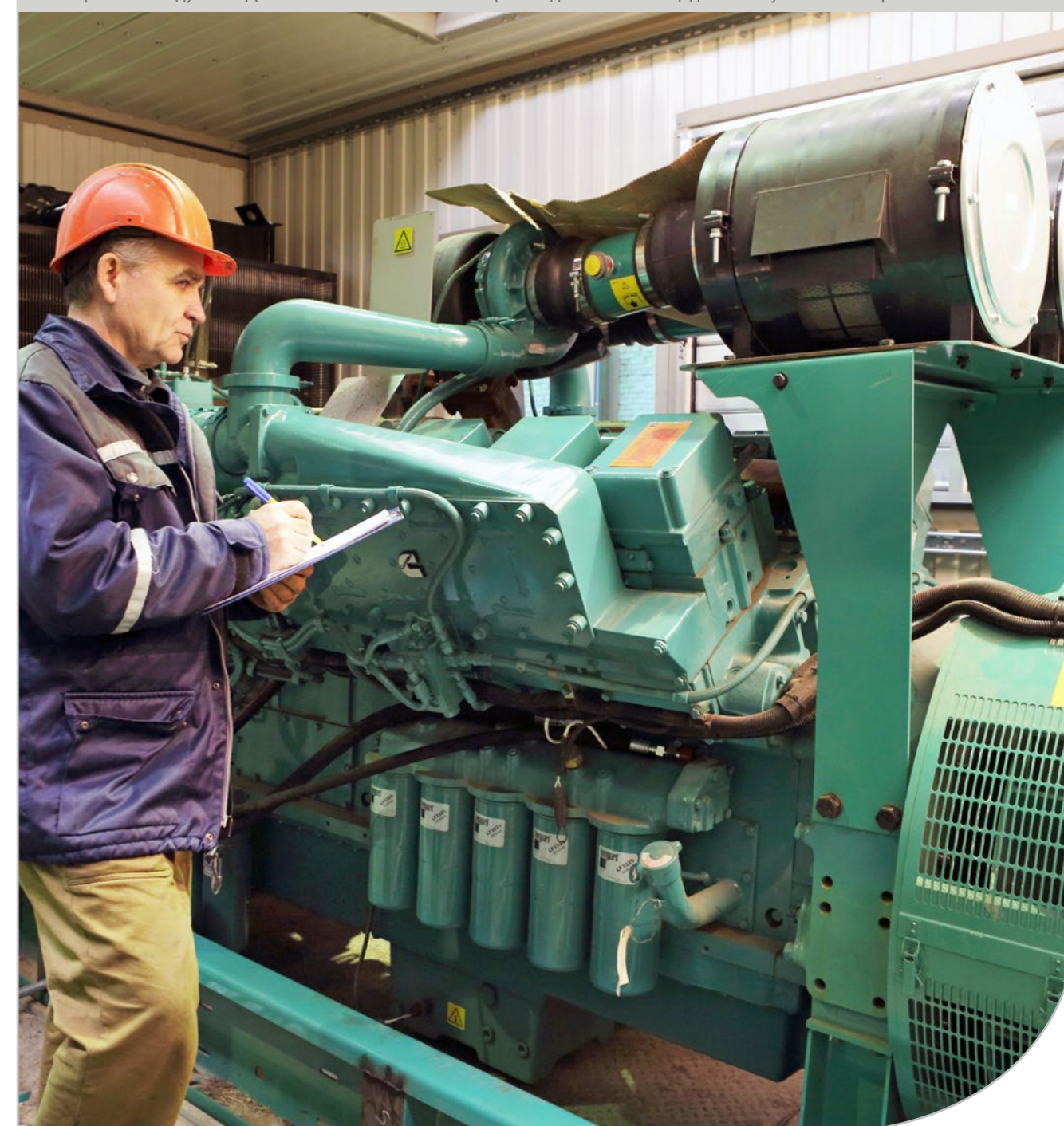
Тестирование модульной ДЭС «Cummins C1400 B5» на производственной площадке АО «РусАтом-ЭлектроТехМаш»
